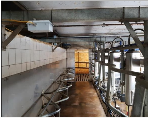
Abbildung 8) Basisstation an der Decke eines Melkstandes
